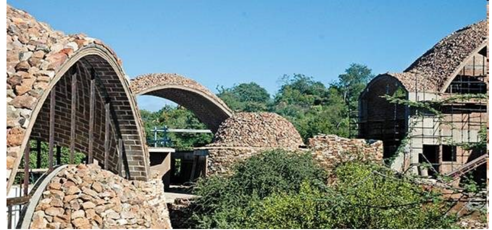
Фигура 249 Черупкова конструкция (каталонски свод), изградена без кофраж от тънки пресовани на място земни блокове с дебелина 10 см. Това е най-известната работа на архитект Peter Rich и инженер John Ochsendorf. Посетителски център в Национален парк Мапунгубве Mapungubwe, Южна Африка. SMITHSONIAN MAGAZINE
