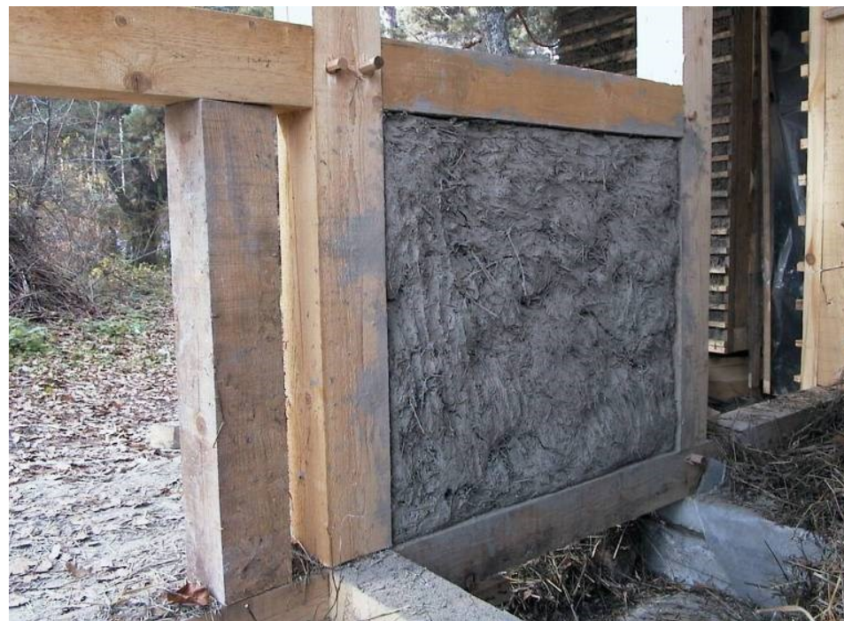
Фигура 94 Ако дървеният скелет ще остане видим, то пълнежът се изпълнява с 1 см навътре, за да може след това мазилката да се изравни с откритите дървени части. Снимка Стефан Шишков
