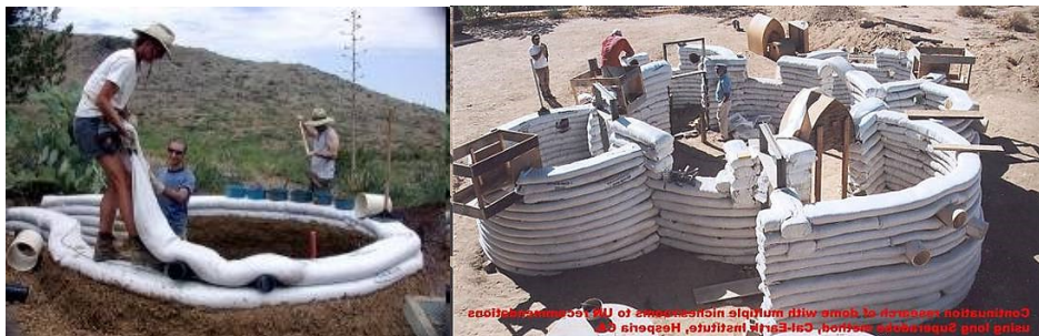
Фигура 254 Строителство с торби с пълнеж от земя. За направа на отворите се използват временни кръжила и подпори.
