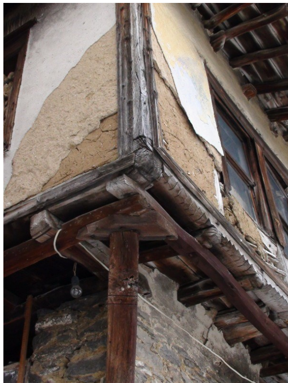
Фигура 311 Повредите по фасадата най-често се дължат на недостатъчно голяма стреха. Ясно се виждат трите слоя – пълнеж на плетарката, глинена мазилка и фина варова пердашена мазилка. Стената може да бъде реставрирана само с изкърпване на повредените места със същите материали. Снимка Ст. Шишков.
