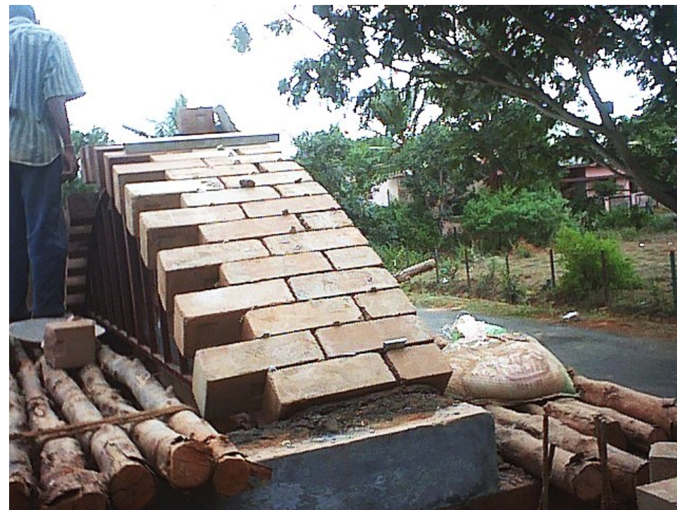
Фигура 230 Строителство на свод от пресовани земни блокове чрез използване на пълзящо метално кръжило. Гр. Бангалор, Индия. Арх. Читра Вишванат
