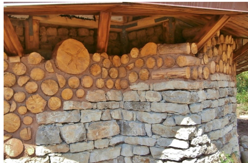
Фигура 115 Изграждане на стена с носещ дървен скелет и пълнежи от кирпич отвътре и с къси дървени трупи, свързани с глинена смес отвън. Къща за гости в с. Извос, Белоградчишко.
